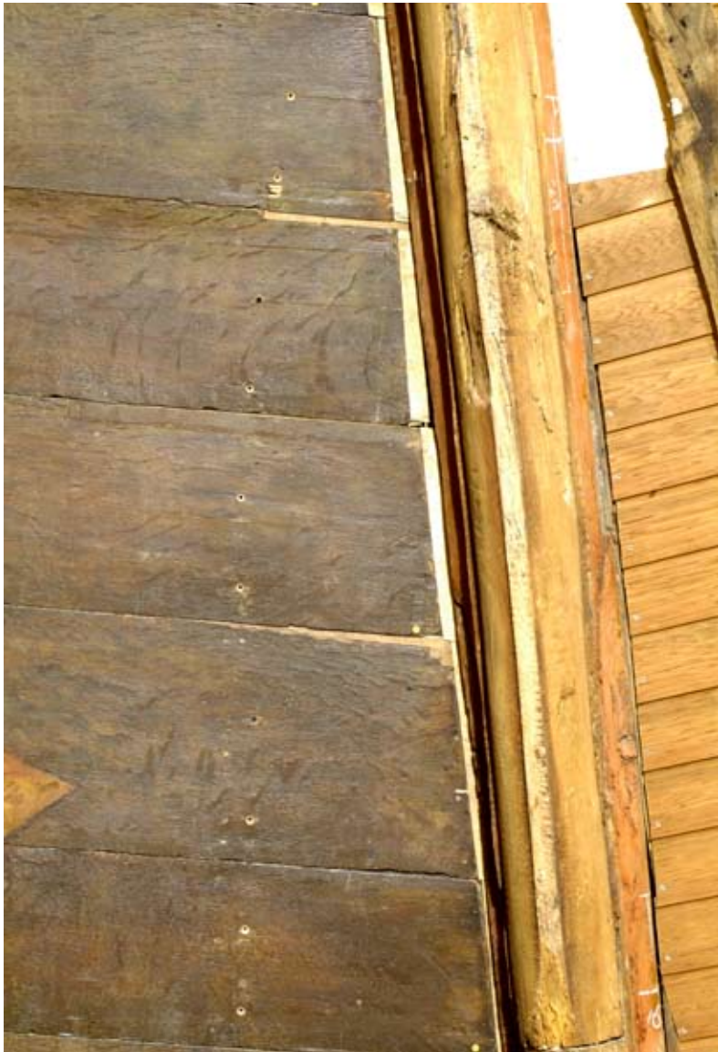
Afbeelding 23: Detail van vak 3 met aanvullende stukken aan de plankeinden.
