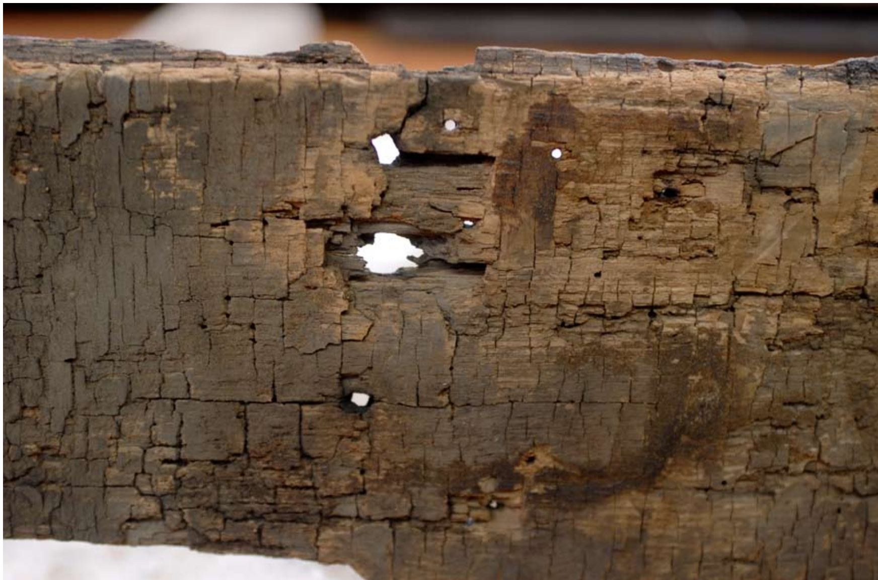
Afbeelding 7: Achterzijde van door houtrot aangetaste plank uit vak 4.
