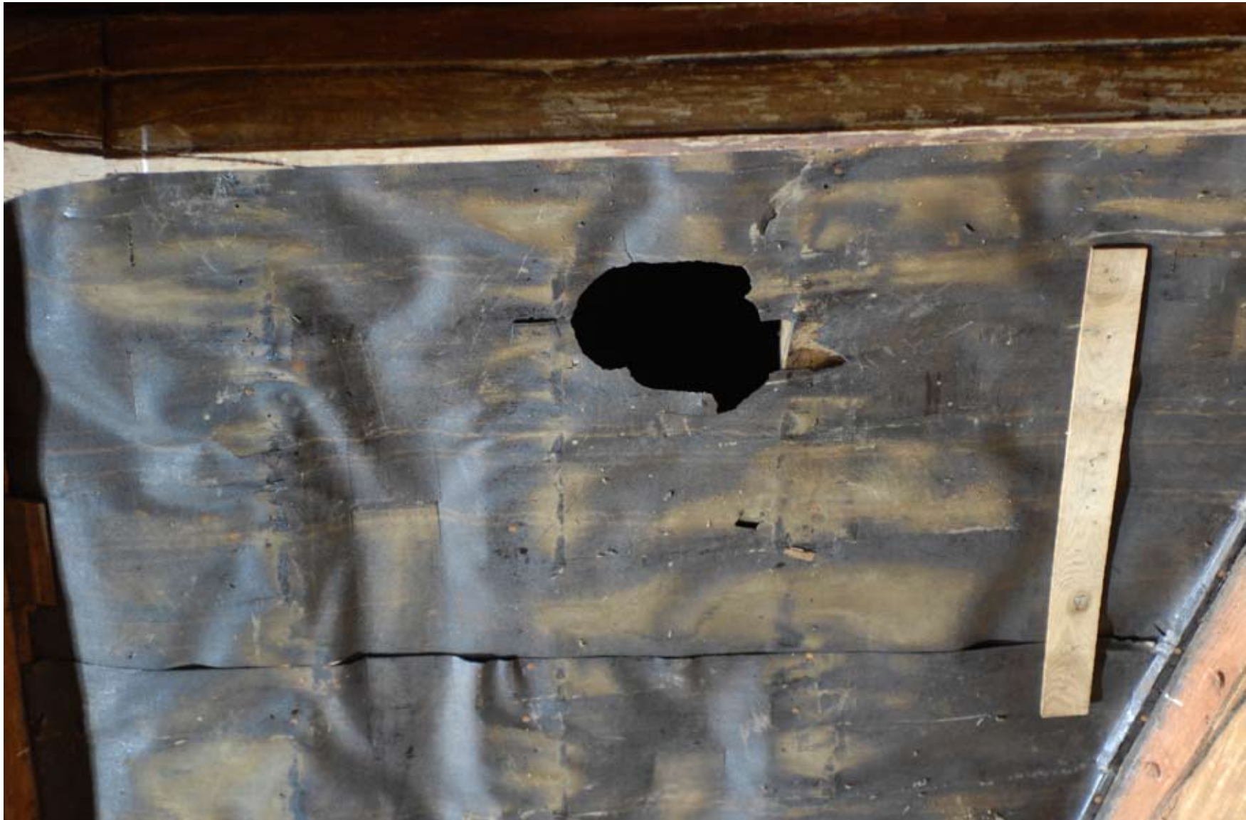
Afbeelding 5: Asfaltpapier, boven in vak 8.
