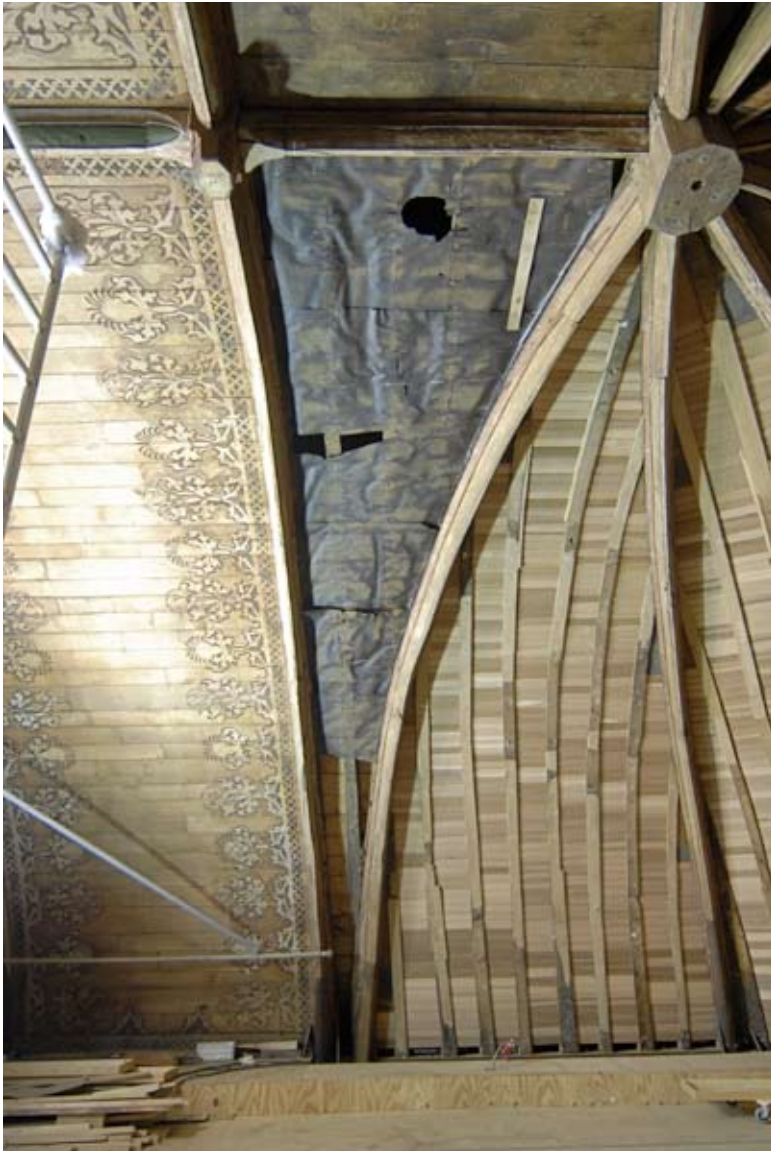
Afbeelding 4: Vakken 6 en 8 (Hemelkant) gedemonteerd. Asfaltpapier uit 1941 nog aanwezig in vak 8.
